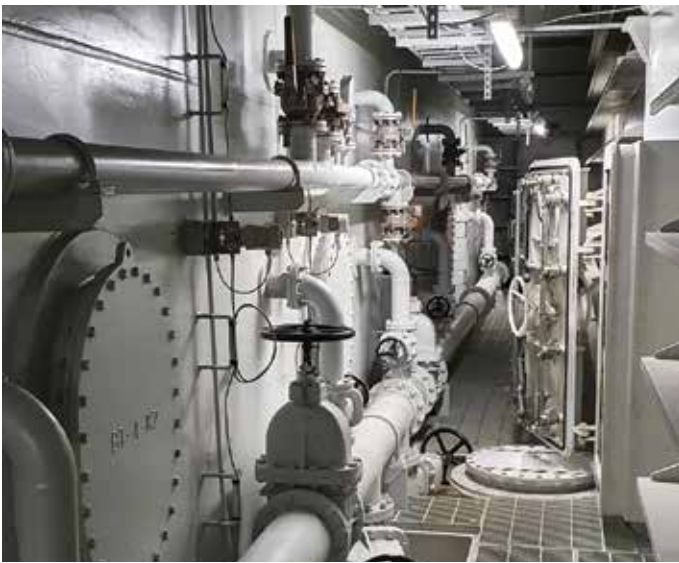
9c. Servicegang drijftanks.
